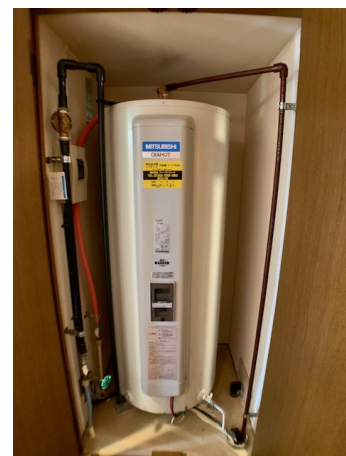
電気温水器 (廊下内設置)
